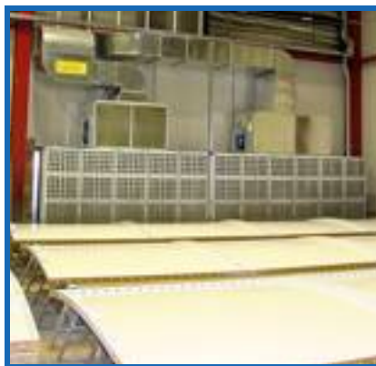
▲ Foto 2 - Esempio di sistema di captazione laterale
