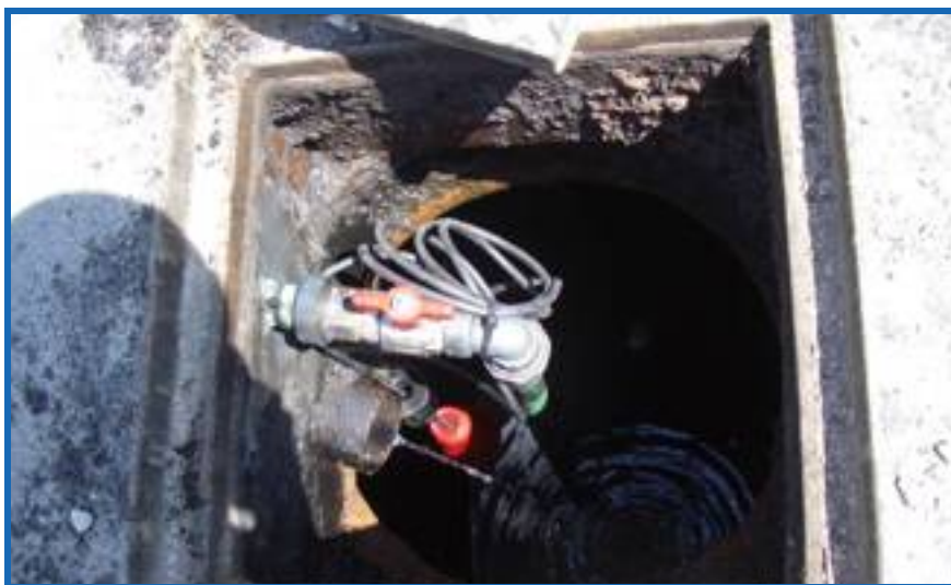
▲ Foto 4 - Accumulo di emergenza del refluo contaminato
