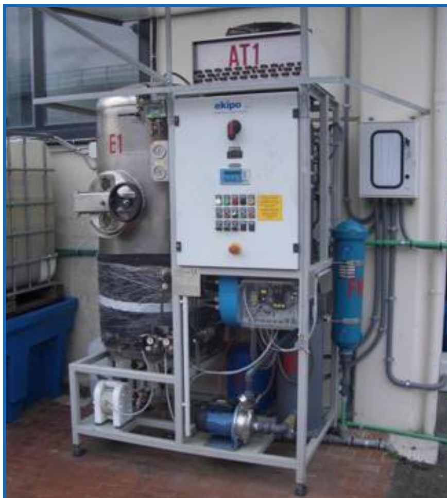
▲ Foto 1 - Impianto di evaporazione sotto vuoto da 700 L/giorno
