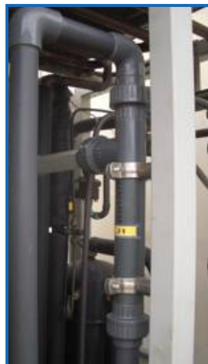
▲ Foto 6 - Particolare della linea del vuoto con l'eiettore Venturi (sulla destra)
