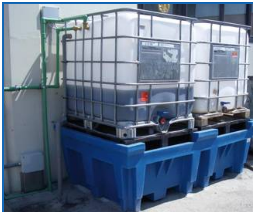
▲ Foto 5 - Serbatoi di stoccaggio della carica (a sinistra) e del residuo di distillazione
