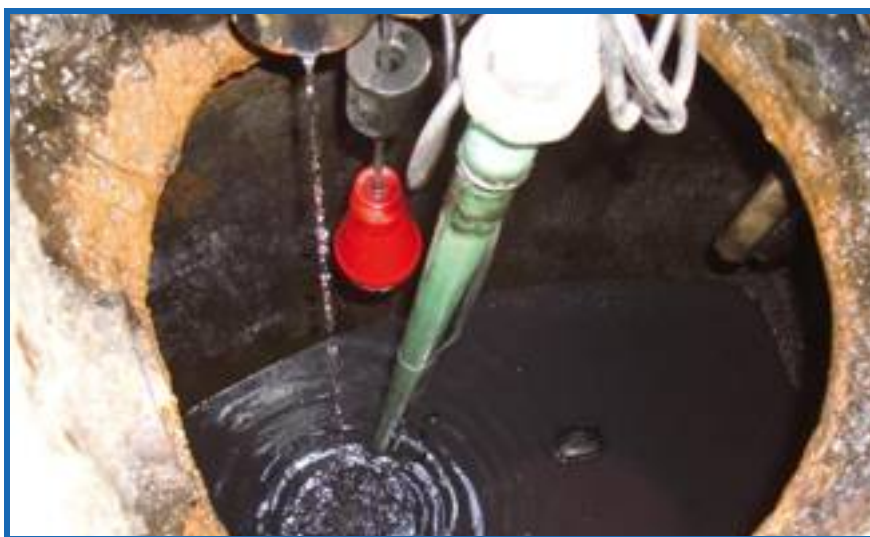
▲ Foto 3 - Stoccaggio interrato del refluo contaminato
