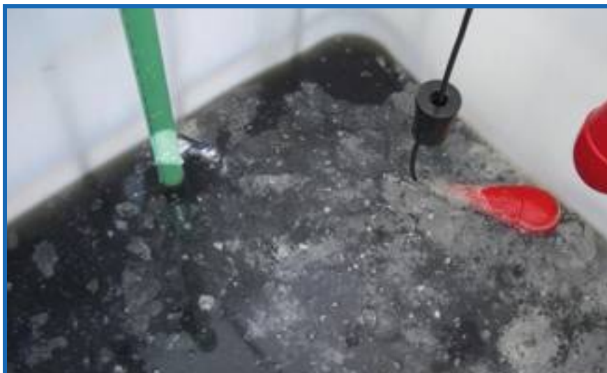
▲ Foto 2 - Rifiuto liquido contaminato da idrocarburi
