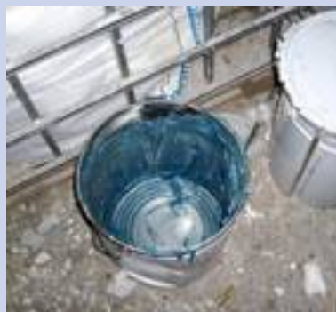
Fusti sporchi di mastice
