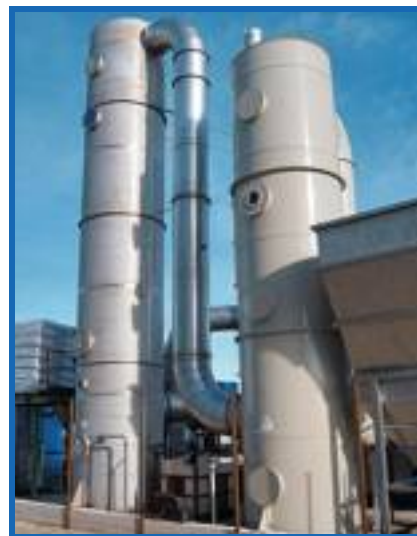
▲ Foto 4 - Colonne di stripping e scrubbing in serie
