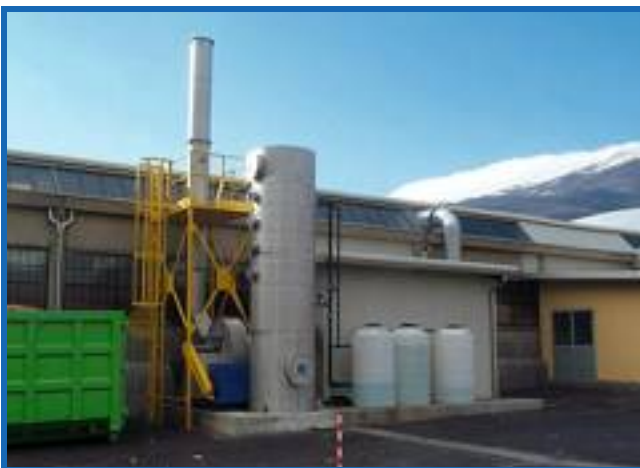
▲ Foto 1 - Esempio di uno scrubber a umido
